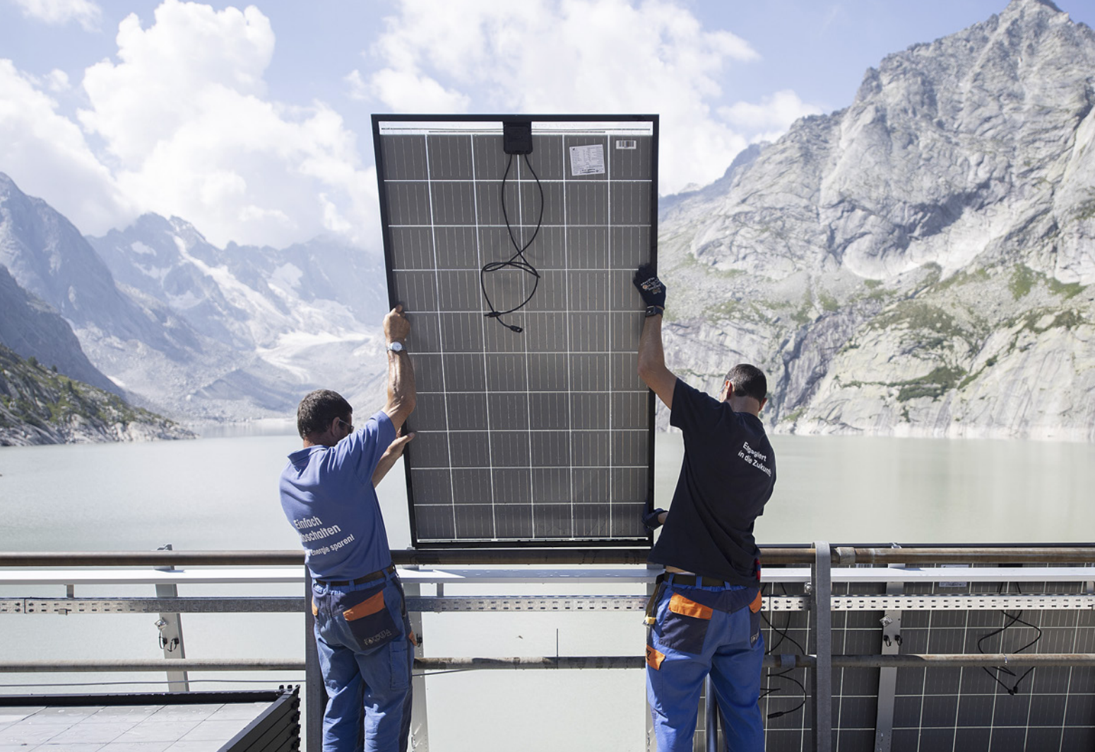
Montage eines Panels der Solar-Grossanlage des Elektrizitätswerks der Stadt Zürich (ewz) am Albigna-Stausee.
